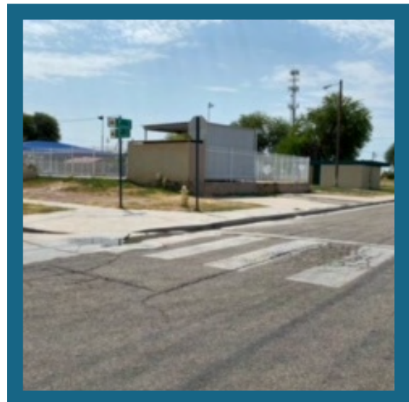
IMAGEN: PASO DE PEATONES SIN RAMPA
